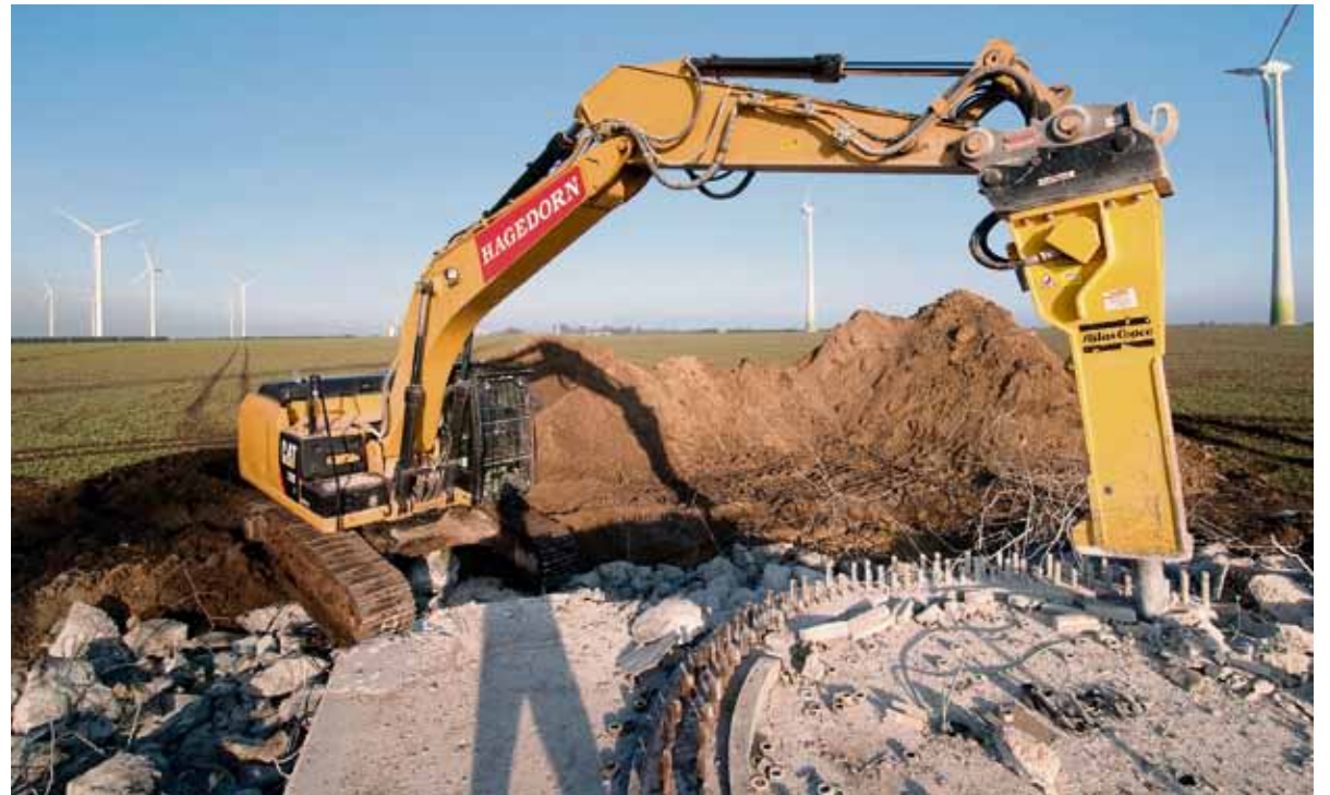
Es kommt darauf an, die tonnenschweren Beton-Fundamente auszubauen und aufzubereiten, die nötig sind, um die meterhohen Türme zu verankern.
