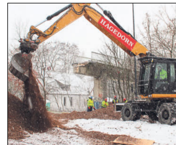
Am Tag danach räumen die Bagger den Schotter von der Straße. Foto: Winkelkötter
