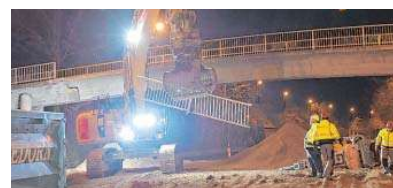
Unkrautzupfen mal anders: Wie lästiges Grünzeug riss der Bagger die Brückengeländer heraus.
