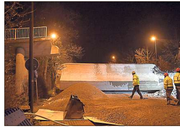
Arbeiter inspizierten die von der Auflage gerutschte Brücke, ehe sie zerteilt wurde.
